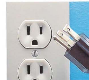
Les prises à trois fils sont maintenant exigées par les codes de sécurité, et elles sont généralement reliées à un système standard à deux fils avec mise à la terre.
