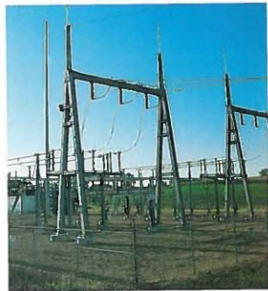
On retrouve des sous-stations près de chaque agglomération qu'elles desservent. Ces sous-stations reçoivent le haut voltage des lignes de transmission et le réduisent, pour alimenter ensuite les lignes de nos rues.
